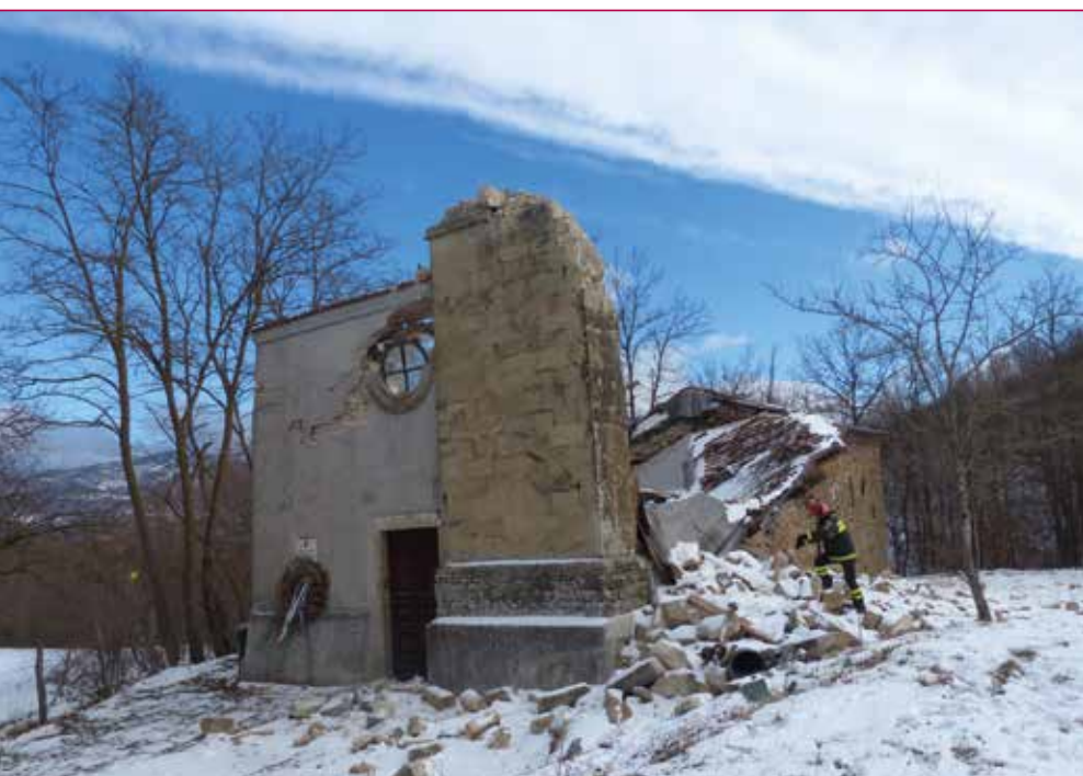
Fig. 1 - Le operazioni di recupero condotte dai Vigili del Fuoco nella chiesa di S. Michele Arcangelo ad Amatrice (RI).
